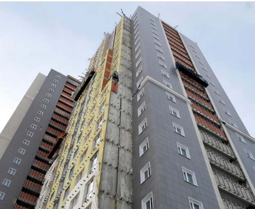
Бывает, застройщик сдает ЖК не в полной готовности. Например, с неработающими лифтами в 20-этажном доме. Необходимо отражать эти моменты в акте, ведь они являются существенным препятствием в пользовании жильем
