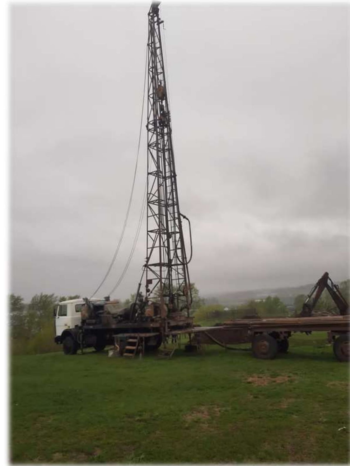
Строительство водонапорных сооружений и прилегающих к ним инженерных сетей в с.Олуяз, Кукморский район
